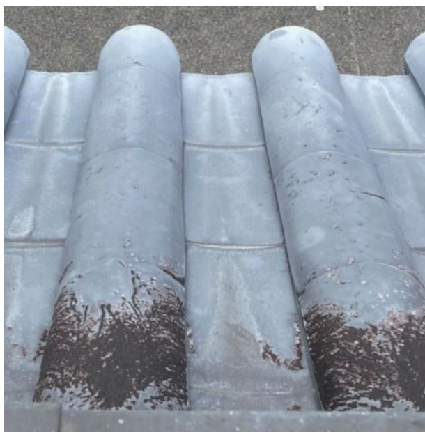
金沢城菱櫓鉛瓦近景（2023 年 9 月 12 日筆者撮影） 至近距離で観察すると鉛が溶出して這った跡とみられるくぼみや汚れやが確認された。
